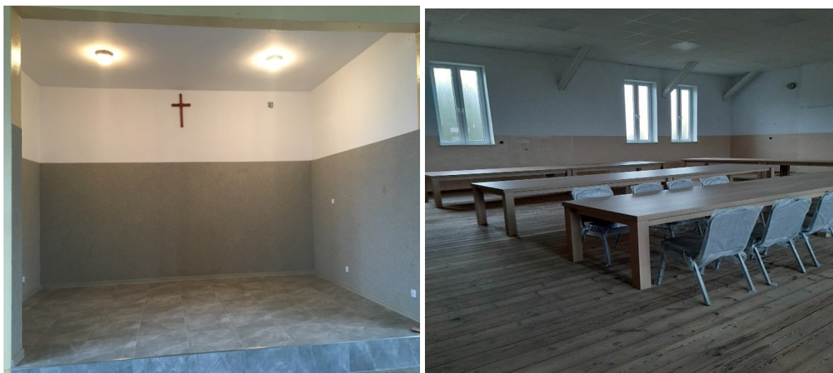
Rysunek 56 Remont podłogi w świetlicy, zakup stołów i krzeseł do świetlicy, źródło: Urząd Miasta i Gminy w Chorzelach
