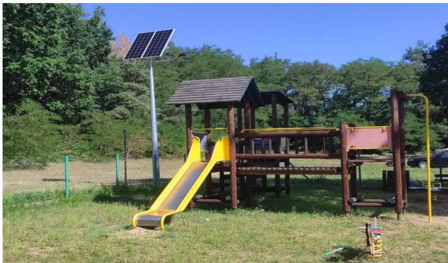
Rysunek 40 Punkt solarnego oświetlenia LED o mocy 60W na placu zabaw w miejscowości Stara Wieś, Źródło: Urząd Miasta i Gminy w Chorzelach.
