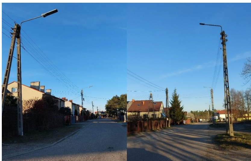
Rysunek 38 Dowieszona oprawy na ul. Jodłowej i ul. Kasztanowej w Chorzelach
