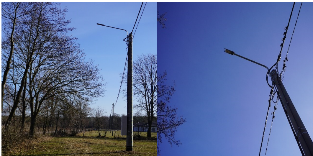
Rysunek 37 Dowieszona oprawa oświetlenia ulicznego LED o mocy 30W w miejscowości Budki, Źródło: Urząd Miasta i Gminy w Chorzelach.
