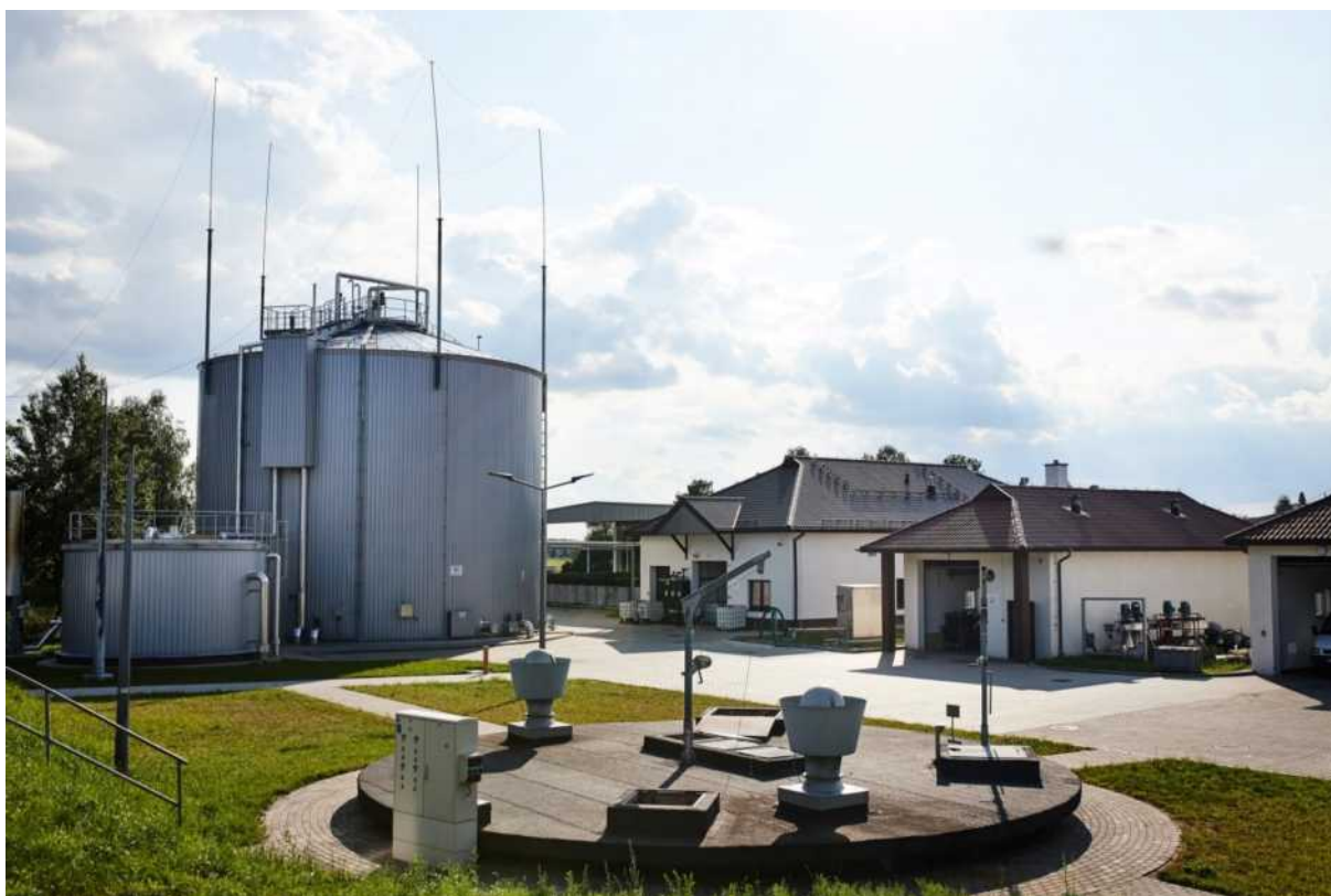
Rysunek 20 Przebudowa i rozbudowa miejskiej oczyszczalni ścieków w Chorzelach, ob. nr 8 budynek technologiczny, źródło: Urząd Miasta i Gminy w Chorzelach.
