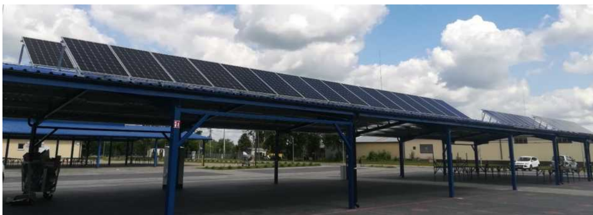
Rysunek 29 Na zdjęciu widoczne są 64 sztuki ogniw fotowoltaicznych o mocy 300W każda, zamontowane na dachu nowej wiaty znajdującej się na targowisku miejskim „Mój Rynek” w Chorzelach, ul. Zarębska, Źródło: Urząd Miasta i Gminy w Chorzelach
